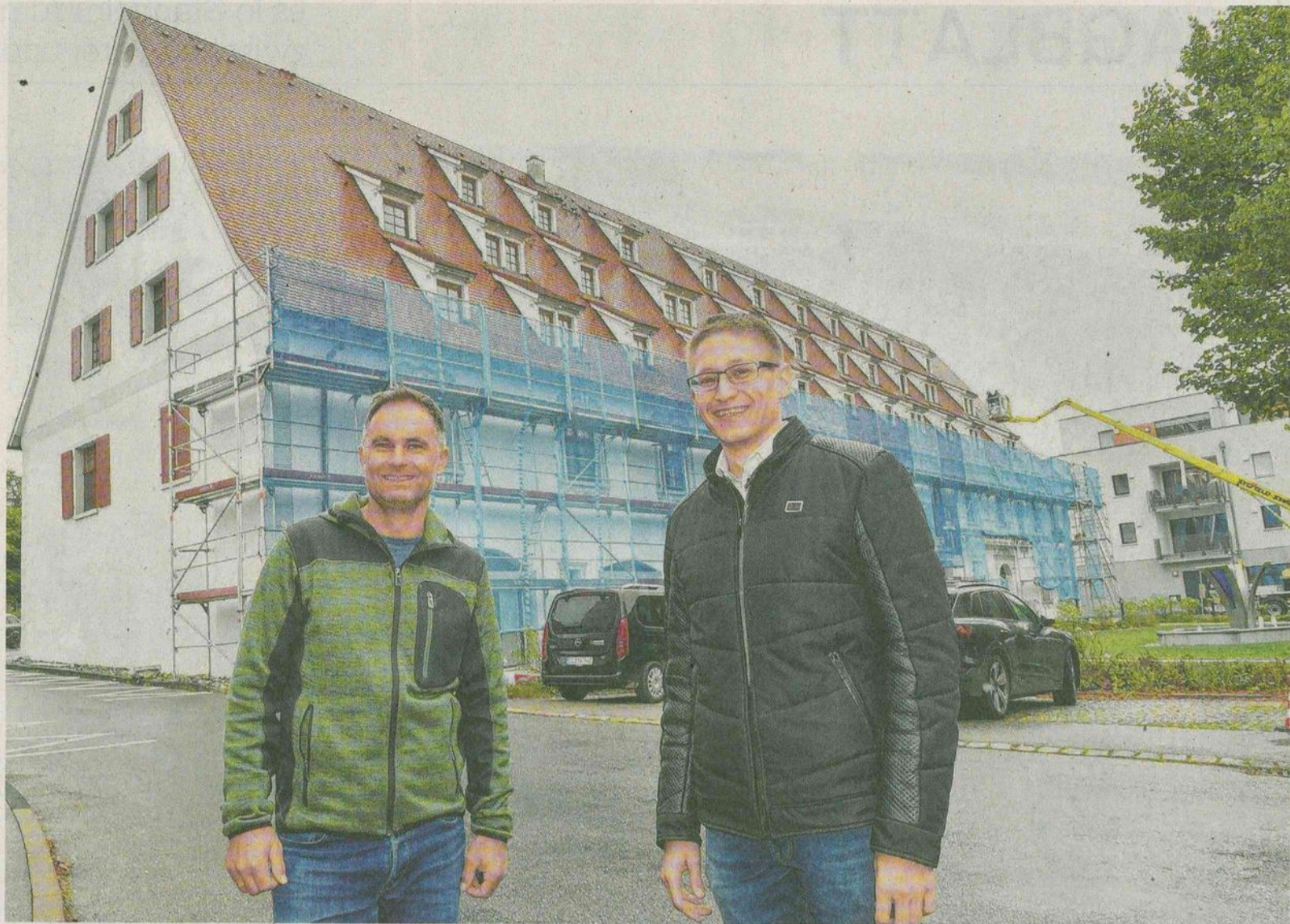
Termin mit dem Experten: Der Öpfinger Bürgermeister Andreas Braun (rechts) und Restaurator Meinrad Kopp aus Emerkingen besichtigen die Sanierungsarbeiten am Unteren Schloss. Fotos: Renate Emmenlauer
